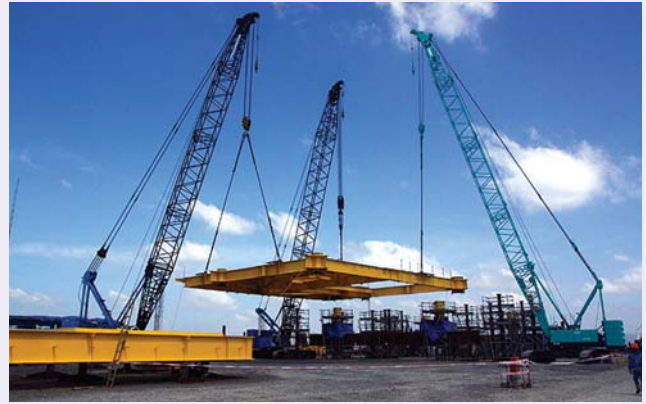
Sàn Cellar Deck - một trong 3 sàn chính của khối thượng tầng giàn đầu giếng H4 mỏ Tê Giác Trắng được lắp đặt thành công. Ảnh: PVC
